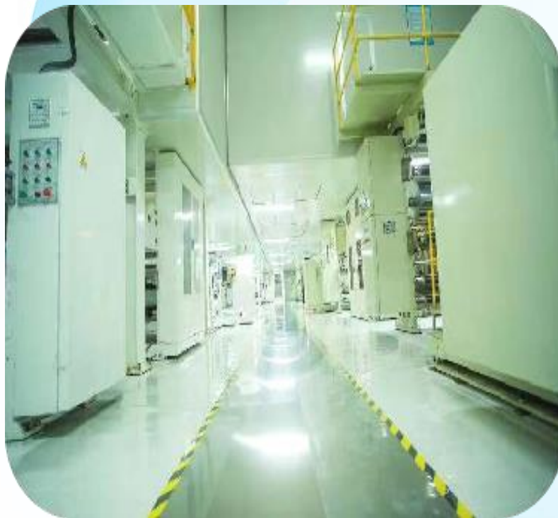
车间(1) 实景图 涂布宽幅 1700mm
