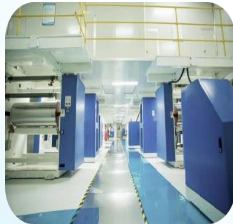
车间(2) 实景图 涂布宽幅 1350mm
